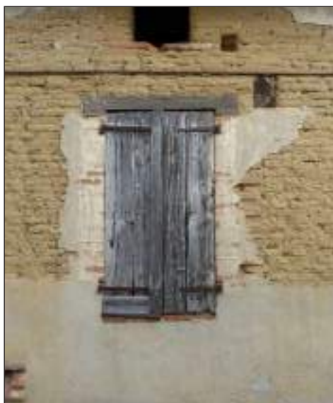
vestiges d'enduit sur parement de briques crues
